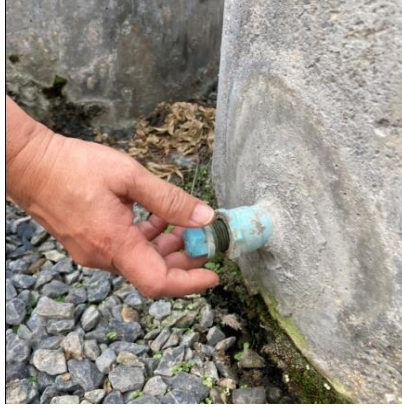
ภาพที่ 7 ท่อระบายน้ำแบบมีฝาปิด เพื่อปรับระดับน้ำในบ่อ
