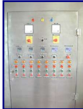
ภาพที่ 6.30 ตู้ควบคุมระบบไฟฟ้า (Electric Controllers)
