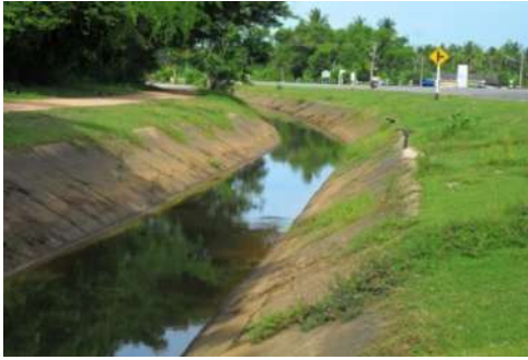
ภาพที่ 1.16 คลองส่งน้ำตาดคอนกรีต (ที่มา : คลองส่งน้ำสายสาม อ.ท่ายาง จ.เพชรบุรี)
