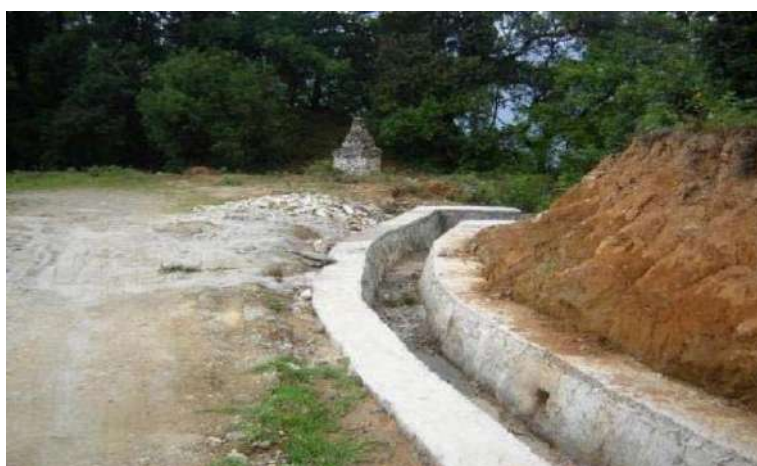
ภาพที่ 9.11 ลักษณะการระบายน้ำแบบสกัดกั้นโดยใช้คูระบายน้ำ (ที่มา : คูระบายน้ำชายเขา ต.หนองพลับ อ.หัวหิน)
