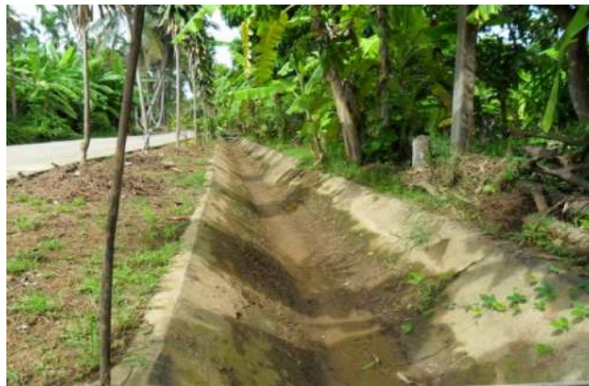
ภาพที่ 9.3 ทางระบายน้ำแบบคูระบายน้ำ (Open Ditch Drain) (ที่มา : คลองส่งน้ำและระบายน้ำ ต.มวบปลาเค้า อ.ท่ายาง)
